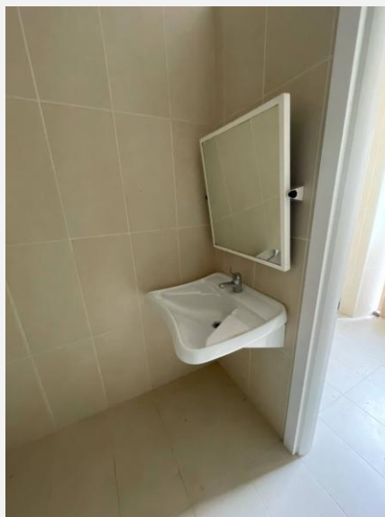
Assenza simbolo accessibilità su porta di ingresso al bagno e assenza ciambella sul wc
