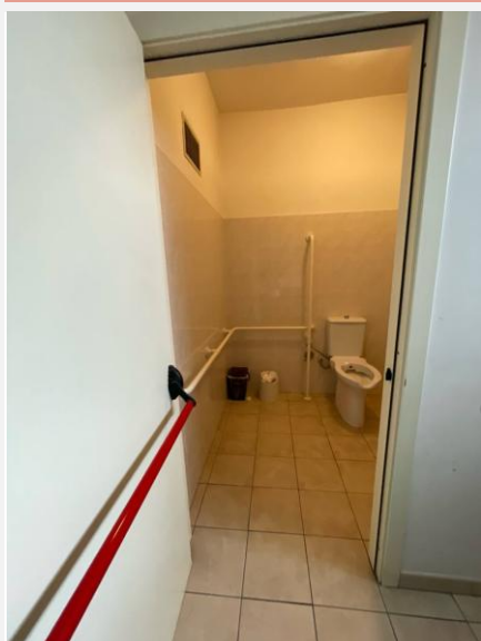
Bagno riservato ad utenti con disabilità posto al piano -2, sprovvisto di ciambella sopra al wc, specchio reclinabile sopra lavandino e simbolo accessibilità posto sulla porta d'ingresso al bagno
