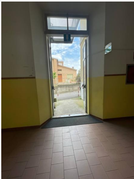
Uscita di emergenza al piano terra con gradino di 3 cm
